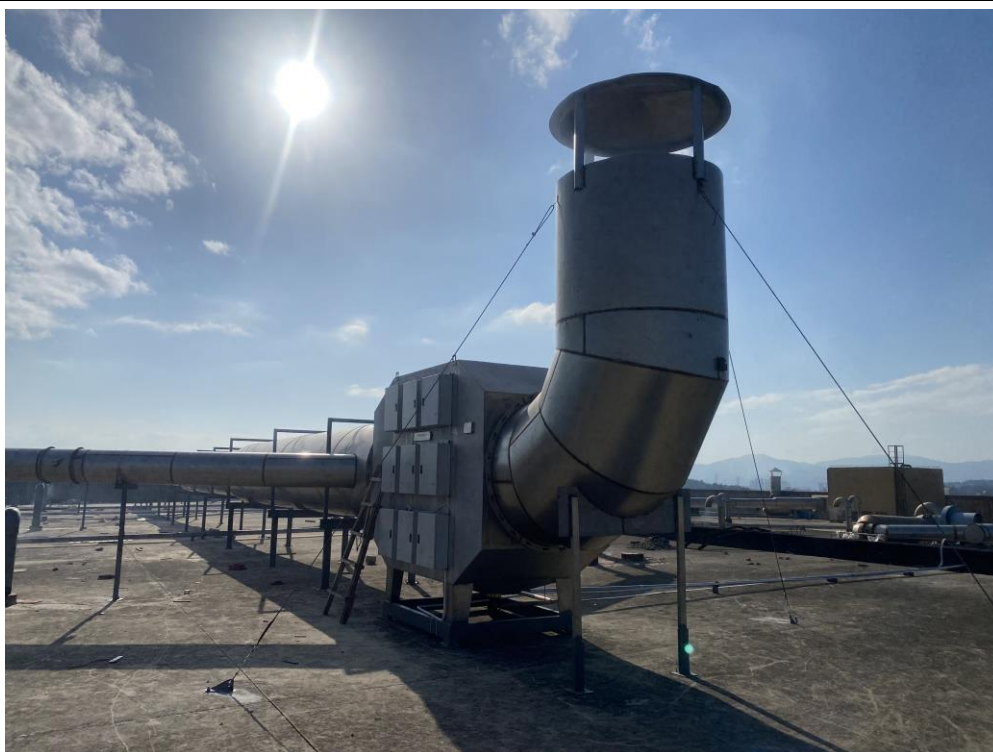
废气治理设施
